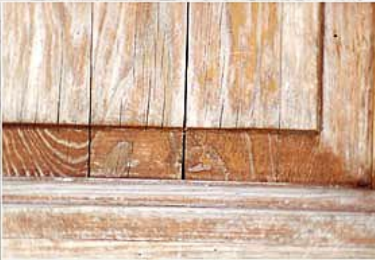
Figura 3. Separación de listones de madera por efecto del hinchamiento y la contracción en una puerta de exterior.
