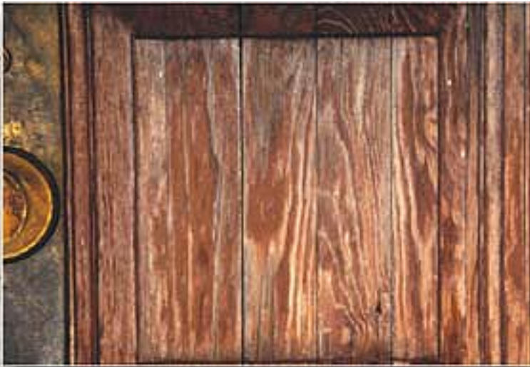
Figura 2. Puerta de exterior que muestra la separación causada por el hinchamiento y la contracción.
