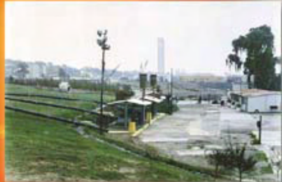
Figura 4. Quemadores de gases instalados en Prados de la Montaña.
