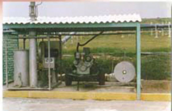
Figura 5. Aproximación de los quemadores de gases instalados en Prados de la Montaña.
